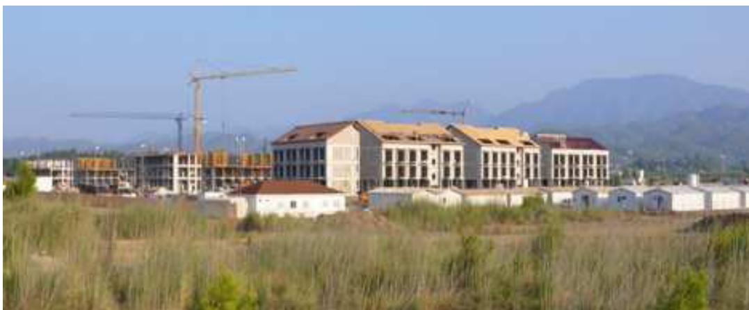
Fig. 58: Construction site Barut Hotel Fethiye (Photo: M. Stachowitsch) Abb. 58: Baustelle Barut Hotel Fethiye
